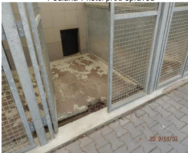
Podlaha v kotci před opravou
