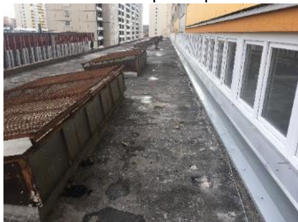
Tř. E. Beneše před opravou
