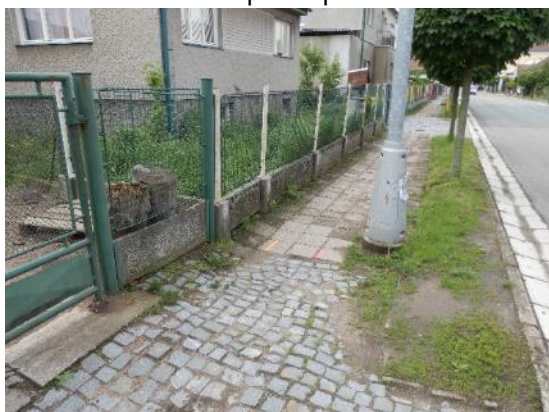
Hradecká ul. před opravou
